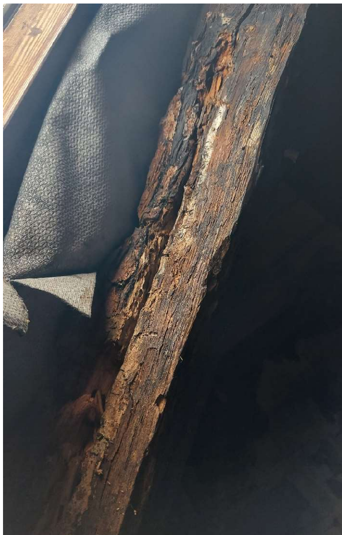
Fot. 5 Widok na elementy konstrukcyjne zdegradowane korozją biologiczną - krokiew
