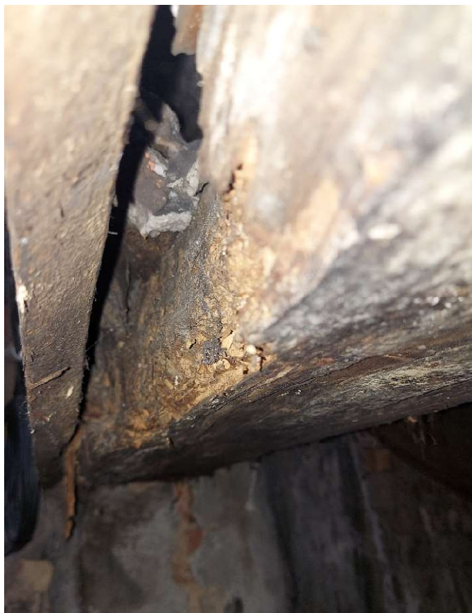
Fot. 7 Widok na elementy konstrukcyjne zdegradowane korozją biologiczną - płatew
