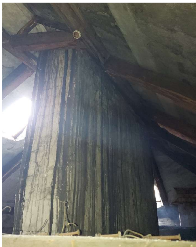
Fot. 4 Widok na oparcie krokwi przy kominie – widoczne źle wykonana obróbka komina, czego efektem są widoczne zacieki na tynku w obrębie komina
