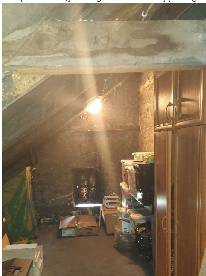
Fot. 8 Widok na elementy konstrukcyjne zdegradowane korozją biologiczną - kleszcze
