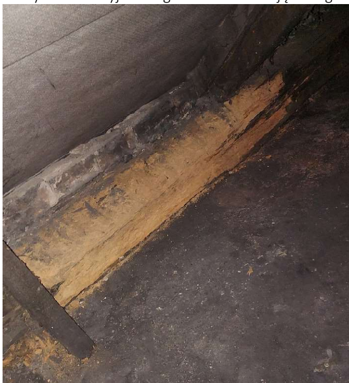
Fot. 6 Widok na elementy konstrukcyjne zdegradowane korozją biologiczną – murłata
